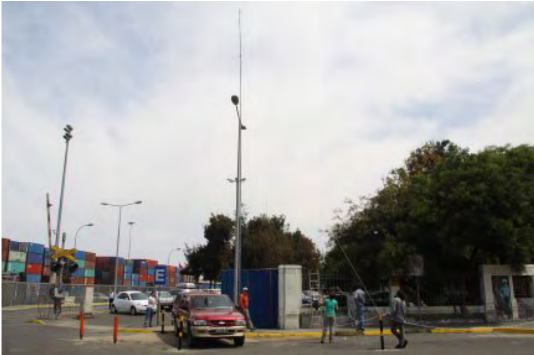
Instalación de soportes de Red de Niebla para capturas de Cormorán Yeco en sector Puerto de Antofagasta.
